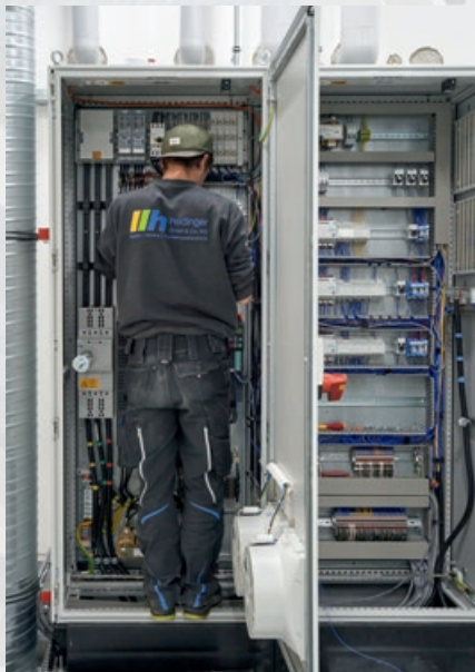
Automatisiert und fernüberwacht: Hellgraue Schaltzentrale von Heidinger.
