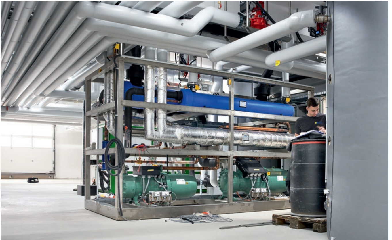
Live bei der Inbetriebnahme: 2-stufig aufgebautes Wärmepumpen-Kälteaggregat von Heidinger.
