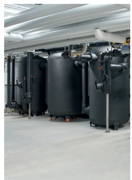
Puffertankbatterie mit in Summe 12.000 Liter Puffervolumen für Wärme und Kälte.
