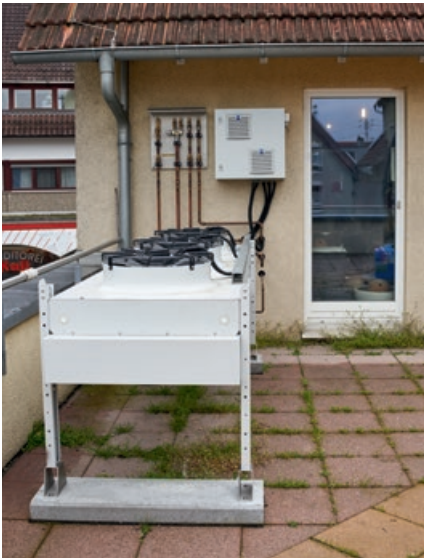
Muss draußen bleiben: Gaskühler mit 40KW Leistung.
