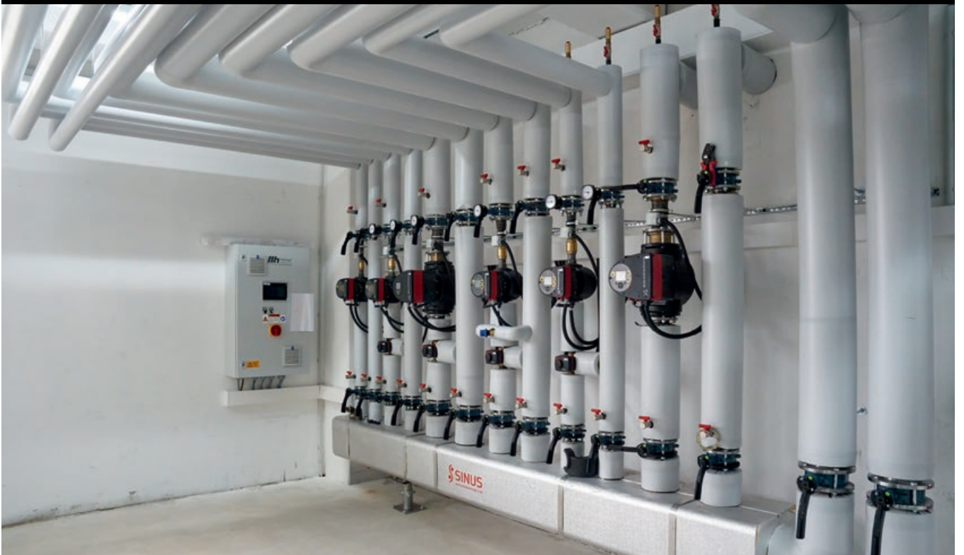
Verteilstation für Prozessmedien, ausgeführt nach neuestem Effizienzstandard.
